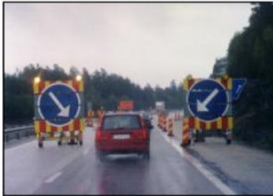
تصویر ۷۱- چراغ چشمک زن روی تابلوهای منطقه عملیات اجرایی، سوئد (توجه کنید که چراغ چشمک زن روی تابلوی سمت چپ و کنار تابلوی سمت راست وجود دارد)
