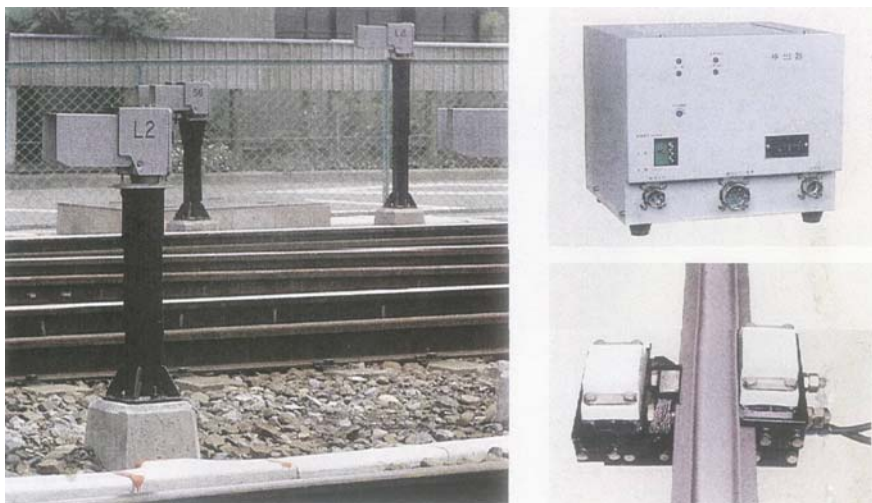
شکل ۳-۹- تجهیزات تشخیص قطار و وسایل نقلیه جاده‌ای برای تقاطع‌های هوشمند [۲۶]
